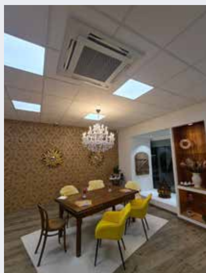
Mureck mobiltelefonbolt, Cool Company Kälte - Klima - Gastro
